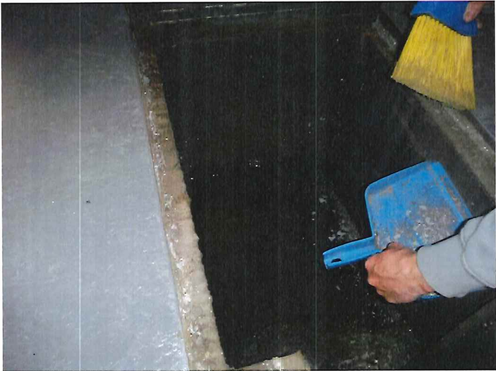
20160707-5.JPG Fosse à sable du caniveau de plancher, relié au séparateur eau/huile.
