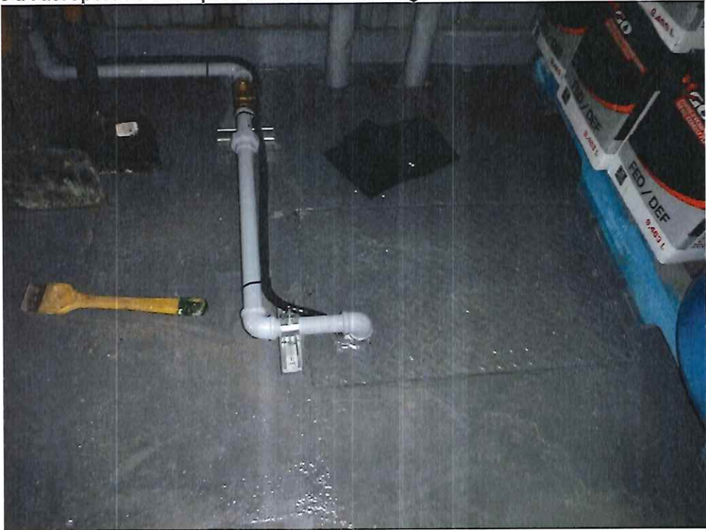
20160707-4.JPG Tuyauterie et l'emplacement du séparateur.
