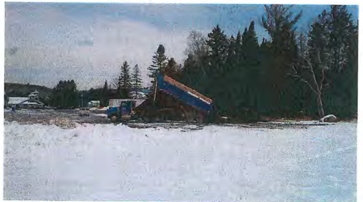
6. Un camion remorque identifié au nom de Daniel Filion Excavation Inc. arrive sur place et dépose un chargement d'asphalte.
