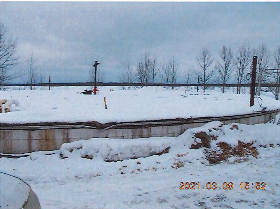
DSCN1396.JPG – Une des unités Biosor ou biofiltre – Voir site #3 annexe 1
