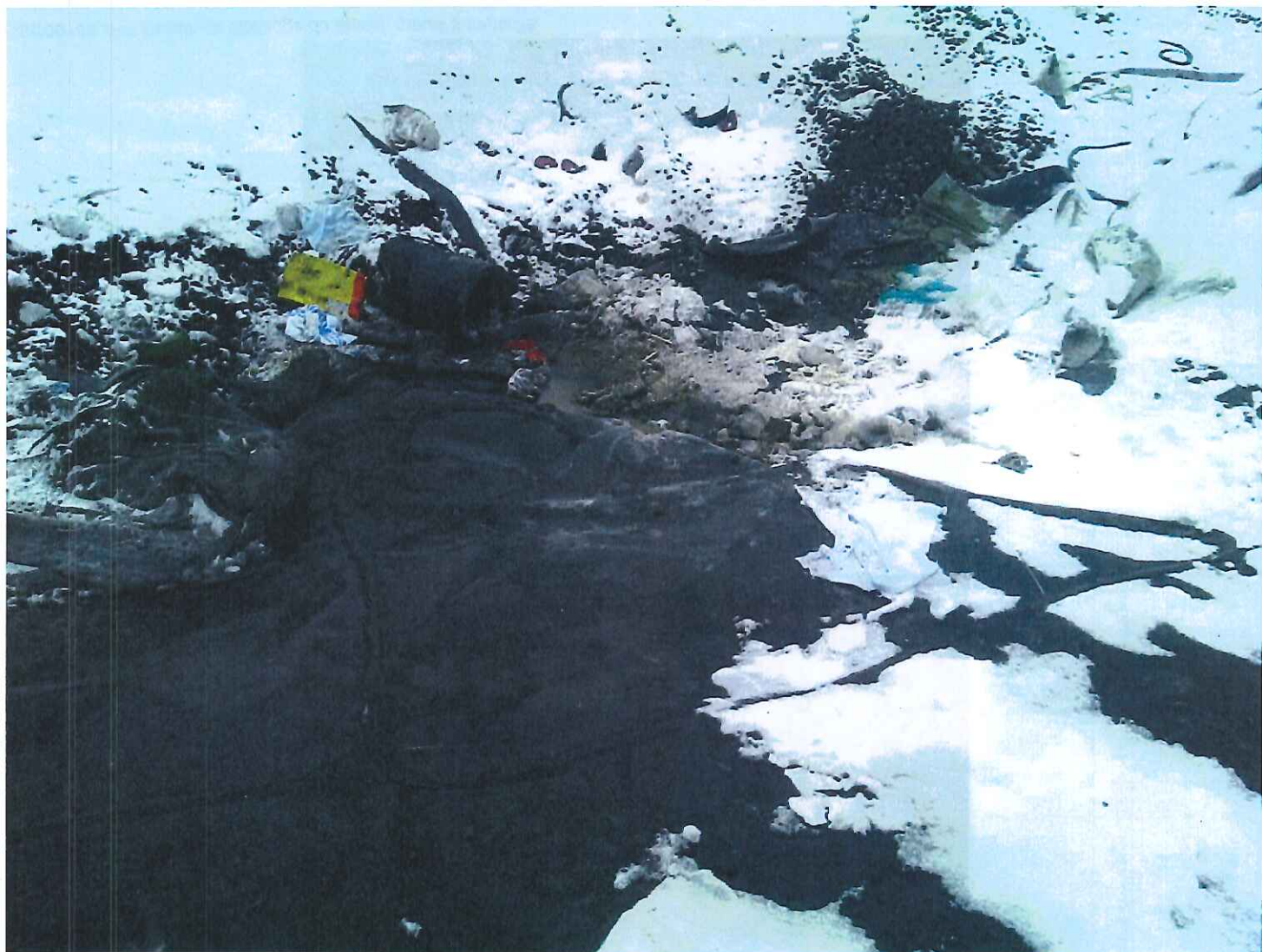
DSC00185.JPG Conduite pluviale, conduite secondaire recouvert de la membrane fusionné et conduite primaire bouchée.
