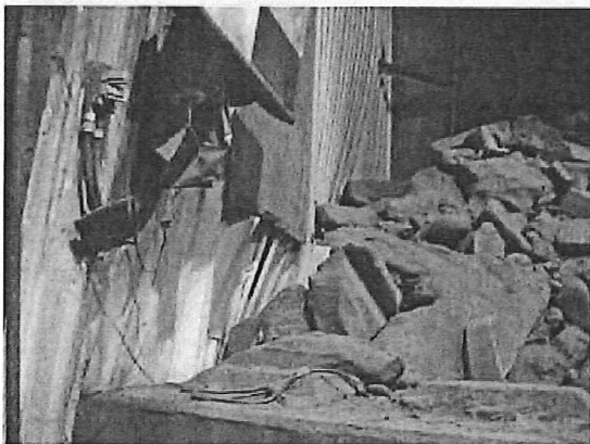
P1060709 (640x480).jpg Image 5. Dommages au mur derrière matériel entreposé.
