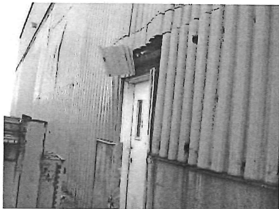
P1060739 (640x480).jpg Image 35. Dommage à la tôle; zone BRP
