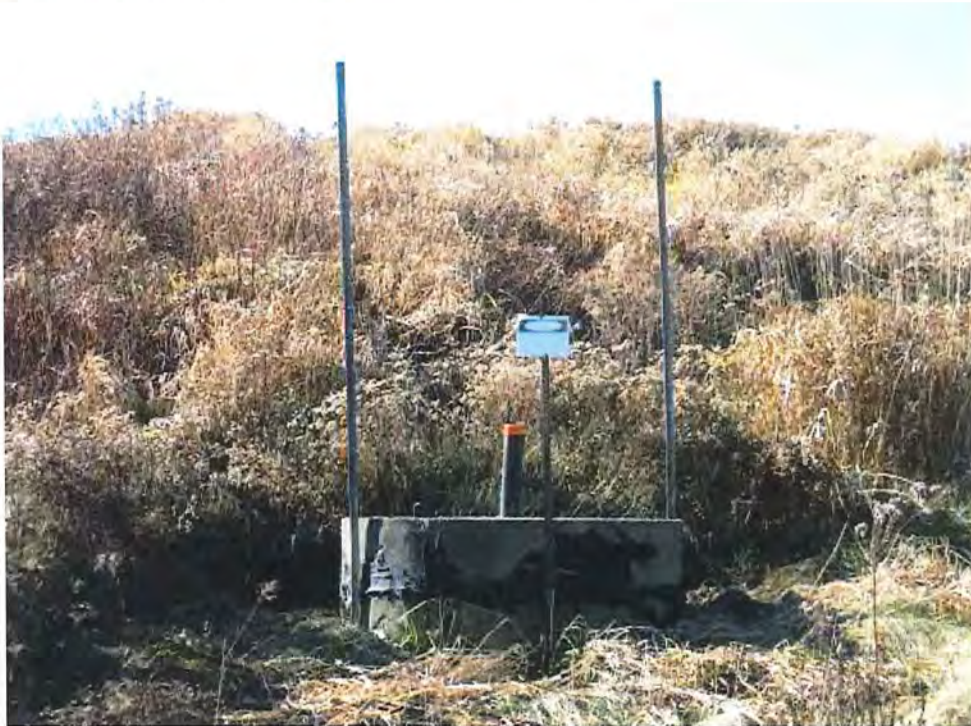
IMG_4574.JPG Image 5. Vue d'une torchère scellée.
