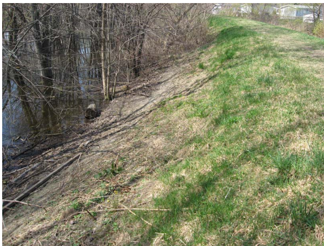
Photo 4 : Érosion moins sévère, secteur nord-ouest
