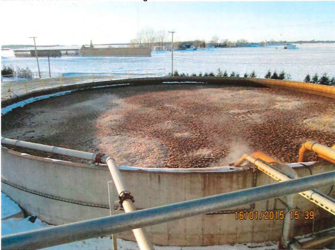
Photo # 15 (IMG_0460 (Small).jpg) Réacteur aérobic
