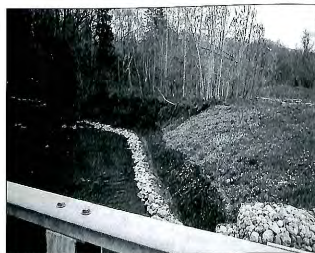
L'enrochement est placé dans le bas de talus et les sections supérieures ont été remises en végétation.
