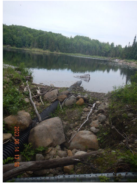
X0004983_2023-06-14 (34).JPG Image 14. Conduite de l'aile gauche, vue de l'amont. Érosion de la crête.
