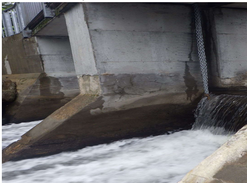
Photo #5: Fissures ouvertes, éclatement et délamination sur des faces gauche et aval du pilier #3.
