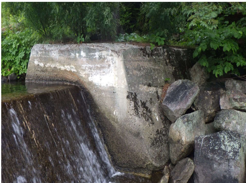
Photo #1: Écaillage, efflorescence et érosion de la culée gauche.
