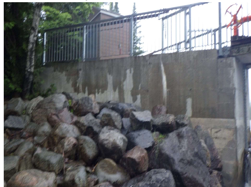
Photo #6: Fissures transversales sur le mur aval de la culée droite.
