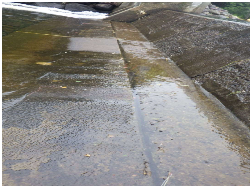
Photo #3: Scellant des joints de construction absent et/ou décollé au niveau du radier aval du déversoir fixe #1
