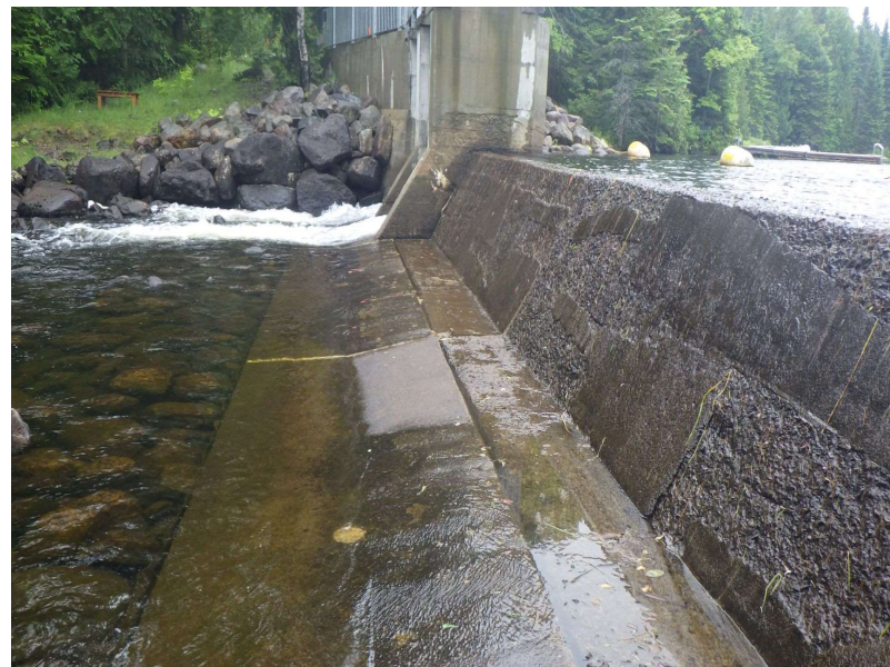
Photo #2: Délaminage et érosion. de la face aval du déversoir fixe #1.
