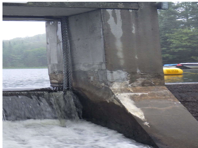
Photo #4: Fissures avec efflorescence sur les faces droite et aval du pilier #2.
