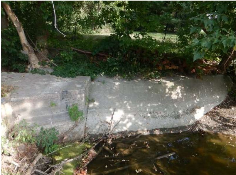
Photo #9 : Partie droite - Érosion dans la zone de marnage et fissures avec végétation
