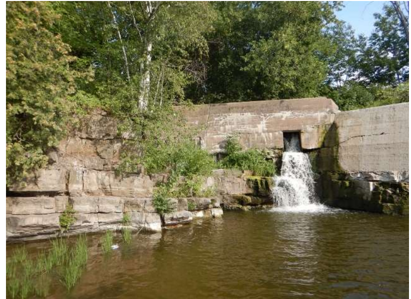
Photo #6: Face gauche du pilier #1: Fissures avec efflorescence et venues d'eau importantes au niveau du linteau et des rainures de vanne.
