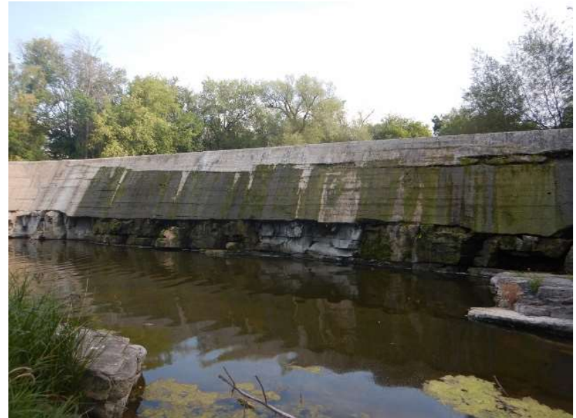
Photo #4: Face aval du déversoir fixe - Fissures longitudinales dans l'axe du barrage avec présence de venues d'eau
