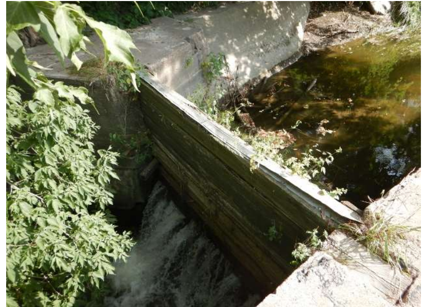
Photo #8: Déversoir à poutrelles - Fuites d'eau importante entre les poutrelles
