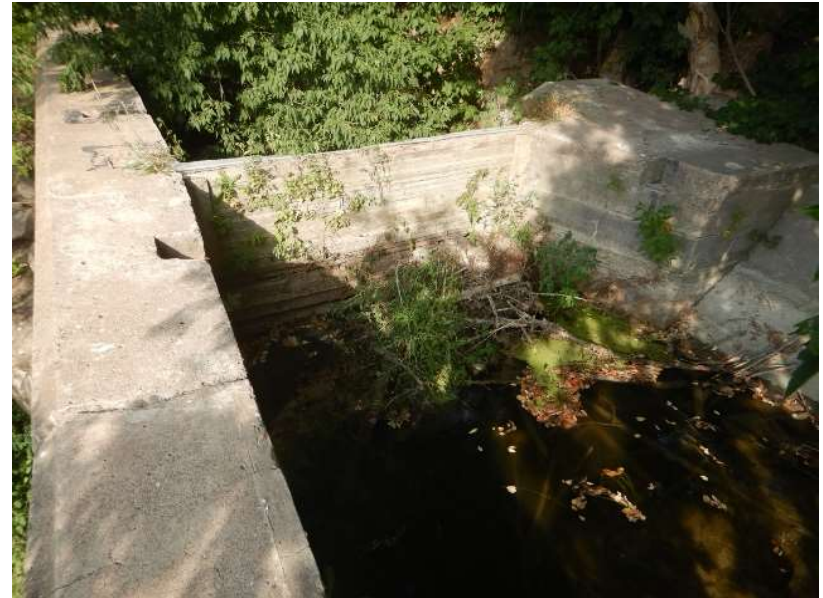
Présence de débris à l'amont du déversoir à poutrelles
