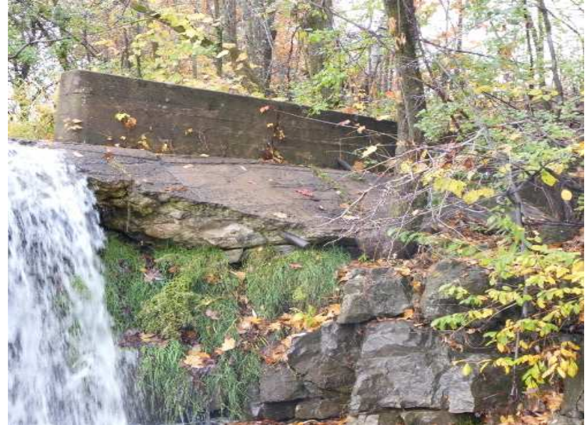
Dégradation du béton
