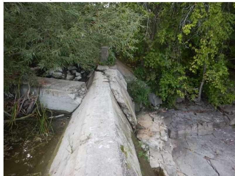
Photo #2: Crête de déversoir fixe à son extrémité gauche - Fissure transversale, perte de section de béton et présence de petits trous
