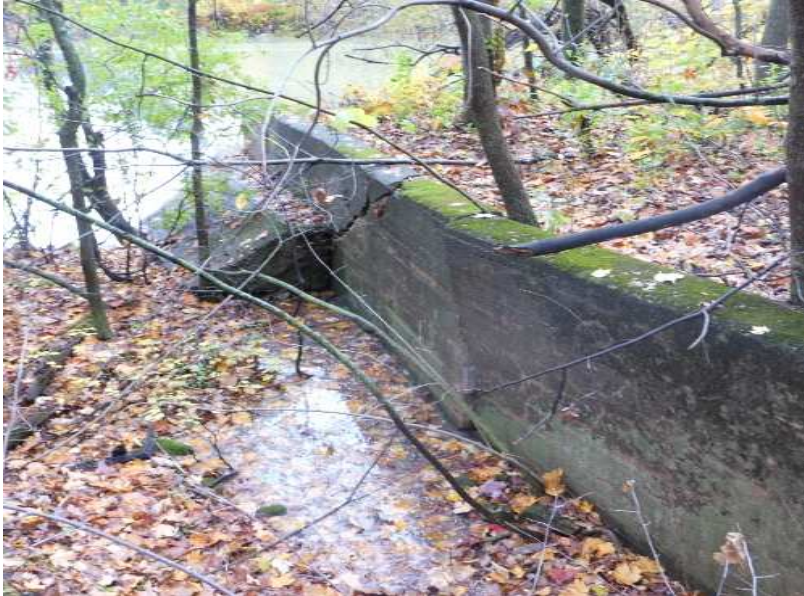
grosse fissures et manque de protections
