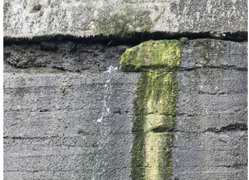
Fuite d'eau au travers du barrage
