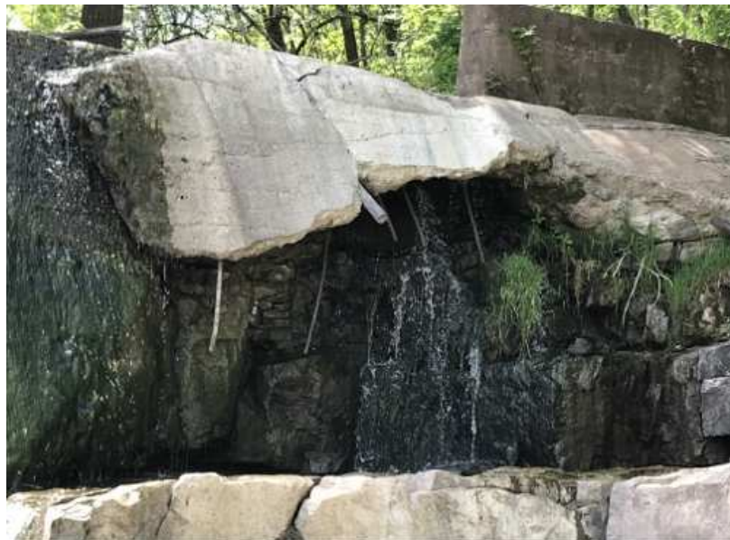
Eau qui coule au travers du barrage
