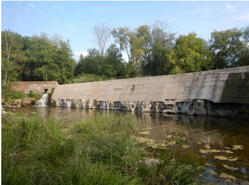
Photo #5: Face aval du déversoir fixe (suite) - Fissures longitudinales dans l'axe du barrage avec présence de venues d'eau
