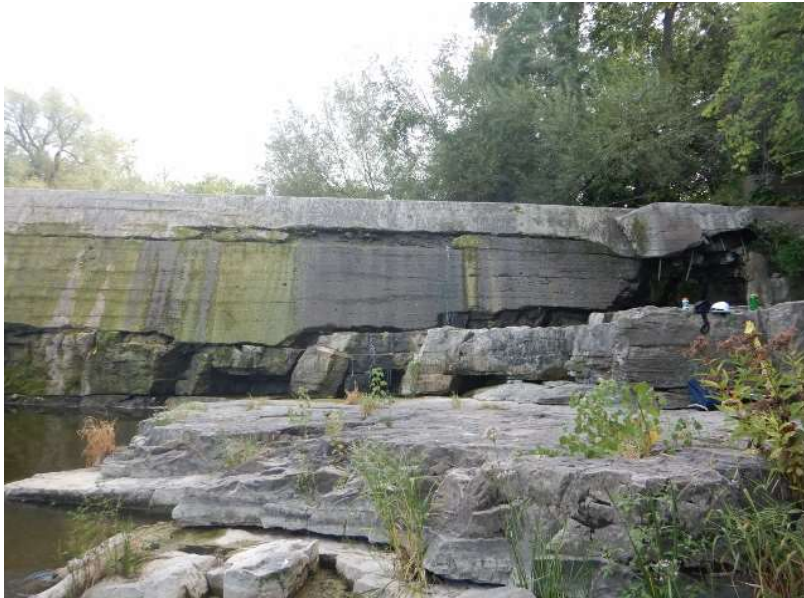
Photo #3: Face aval du déversoir fixe à son extrémité gauche - Fissures longitudinales, éclatement et perte de section de béton
