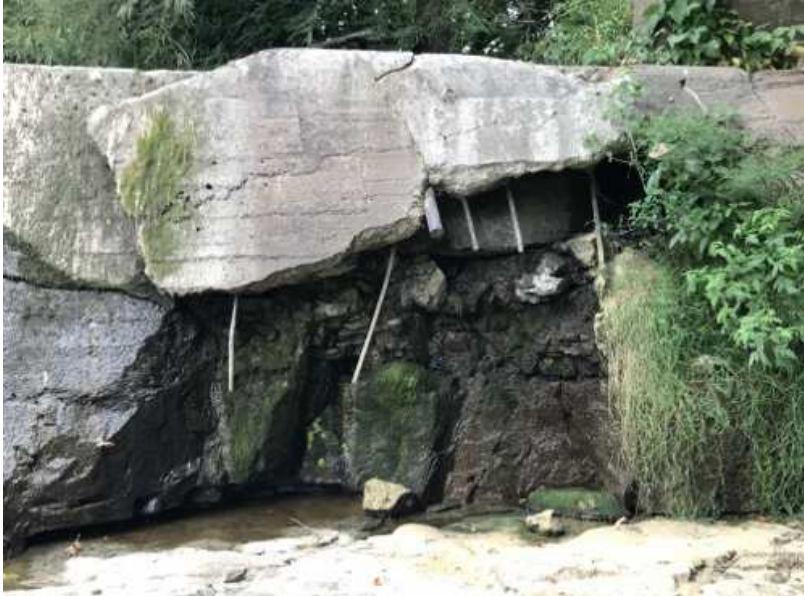
Armature et éclatement de béton
