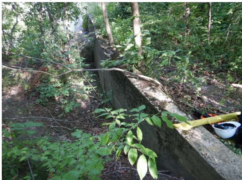
Photo #1: Mur écran gauche - Déversement d'une section du mur.
