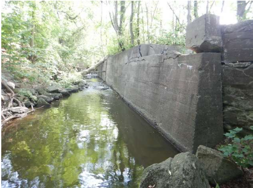
Photo #7: Mur de soutènement aval - Légère inclinaison du mur et fissures horizontales
