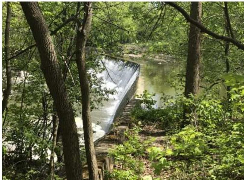
Arbres mature au travers de la structure
