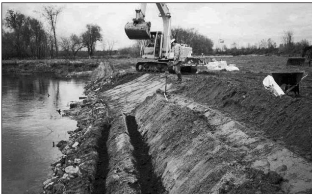
Photo 15 : Travaux de stabilisation des rives : installation de fagots en bas de pente
