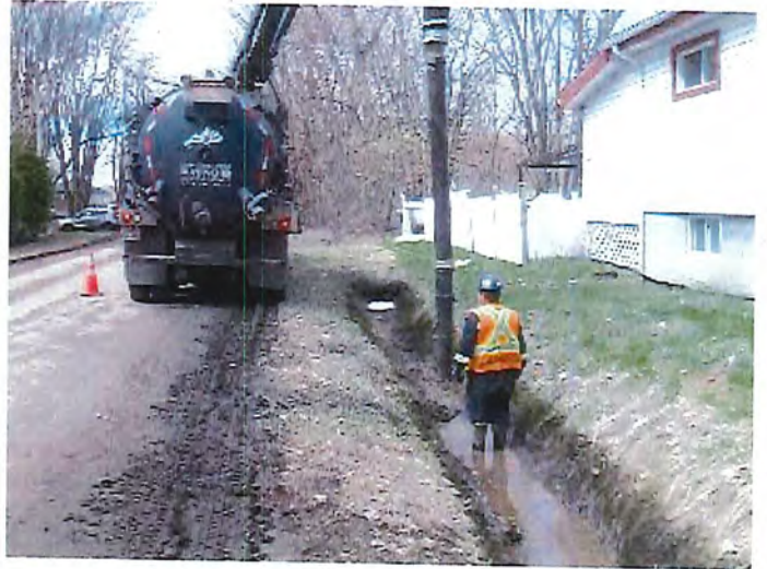
Photo 2; IMG_1600.JPG : Récupération des hydrocarbures dans le fossé nord de la rue sauvé avec un Hydro-Excavateur
