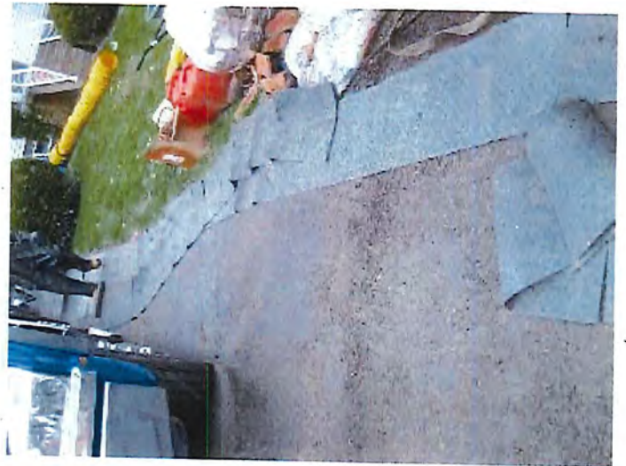
Photo 4 : IMG_1596.JPG 53- 54 22 ème avenue. Tapis absorbant installés pour éviter de contaminer les surfaces extérieures.
