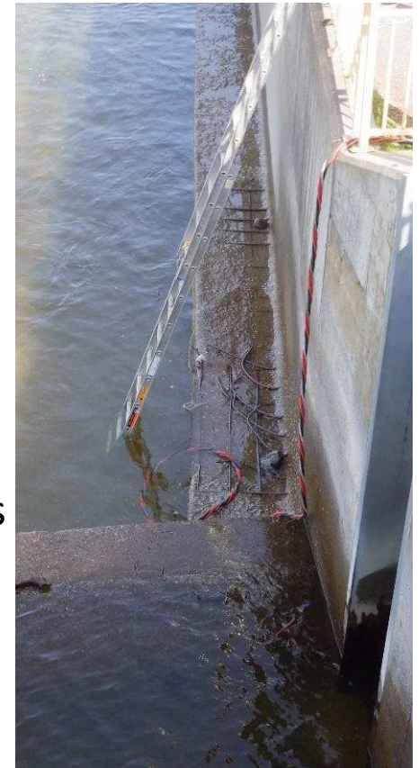
Béton érodé et armatures visibles
