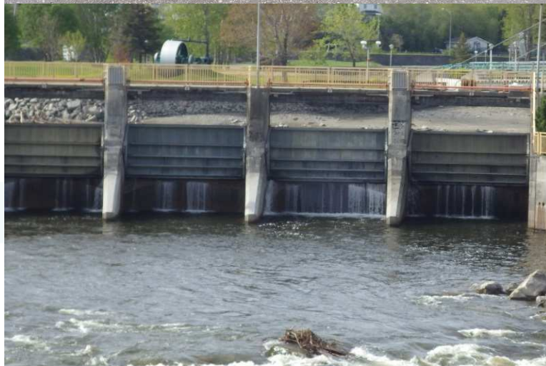
Fuites sous les vannes
