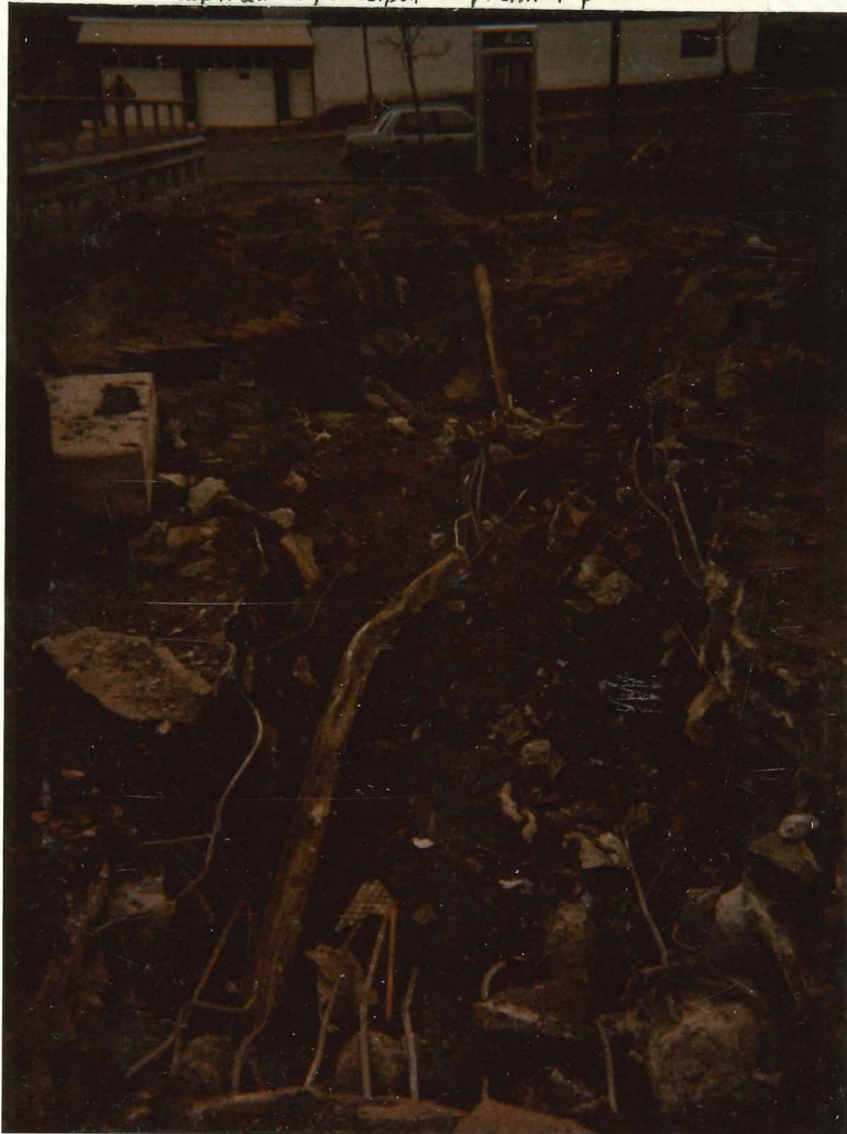
PHOTO 4: CONDUIT D'ÉLECTRICITÉ ENDOMMAGÉ, VUE VERS LE SUD.
