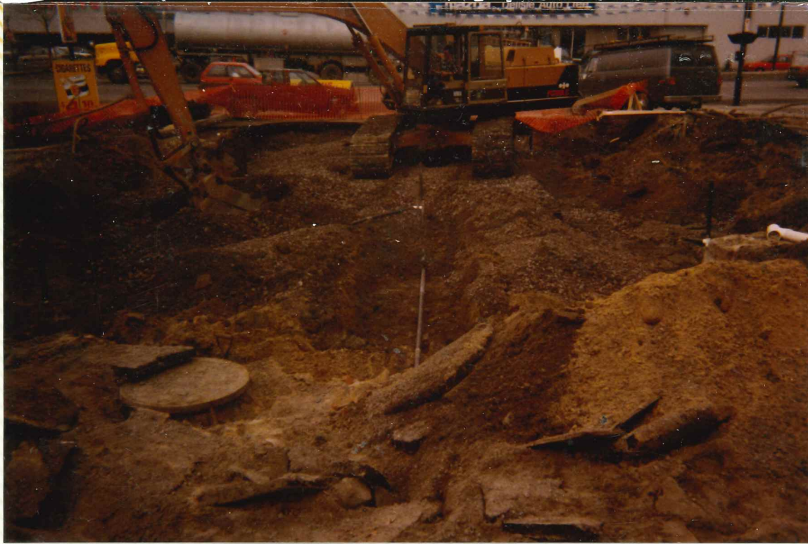
PHOTO 3: Installation du gravier au-dessus le réseau des tuyaux d'aspiration. Tuyau d'aspiration principal au premier plan. Vue
