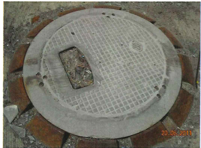
Comdamnation du réservoir d'huiles usées. On peut voir les vis sur le couvercle
