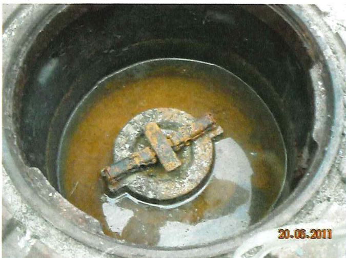
Réservoir de mazout non condamné. Présence d'une odeur de mazout.
