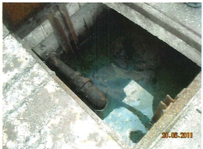
Bassin d'eau fortement contaminé. Odeur pestilentielle et présence d'un film d'hydrocarbure.
