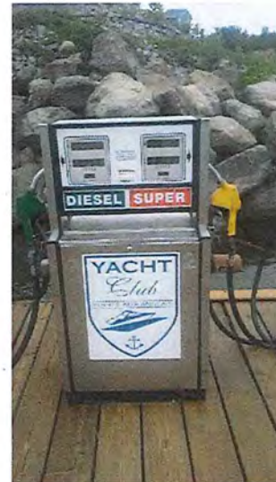
20210708_142851.jpg (Photo 6 : deuxièmes pompe super diesel)
