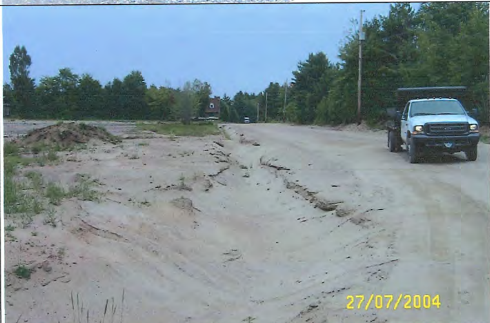
Photo# 5. Vu du chemin au point 5. Fossés non stabilisés.
