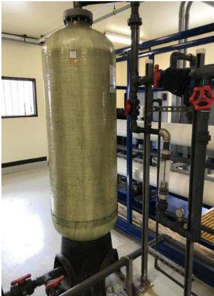
23-IMG_0404.JPG – Aérateur pour enlever les propriétés organoleptiques du soufre dans l'eau
