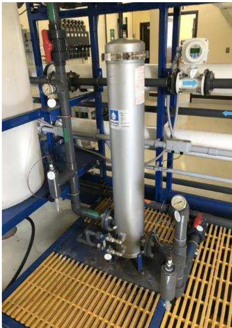
20-IMG_0401.JPG – Filtre grossier non autonettoyant
