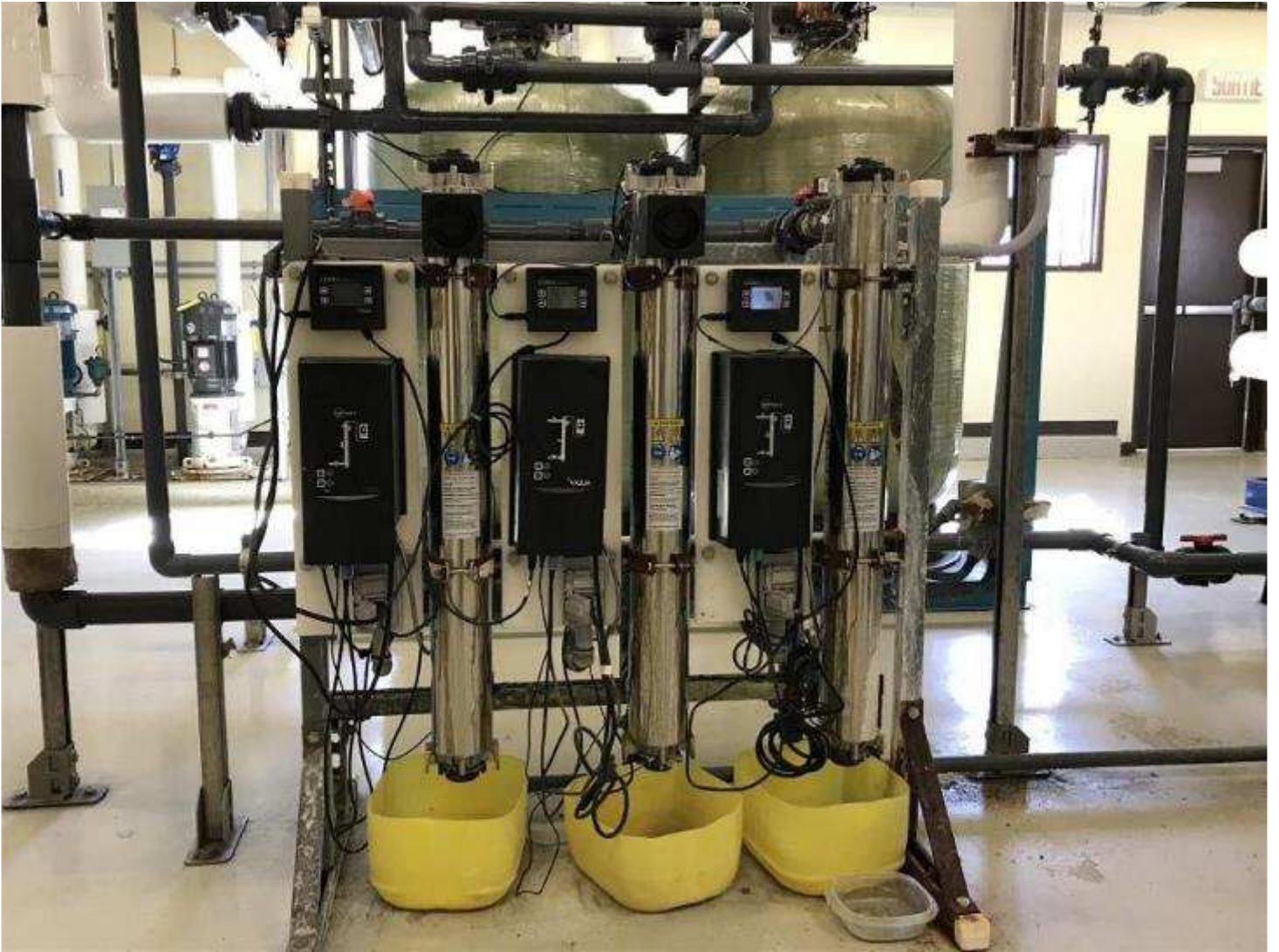
3-IMG_0384.JPG – Système de désinfection UV
