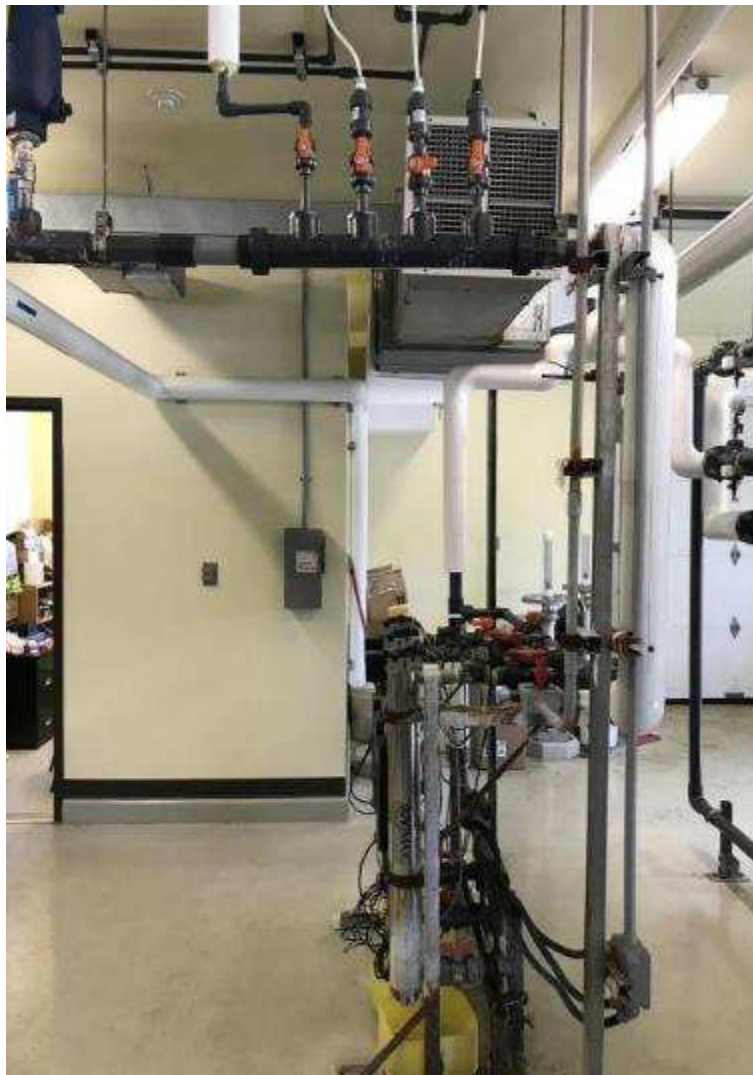
2-IMG_0383.JPG – Point d'injection du chlore (deux tubes de droite)
