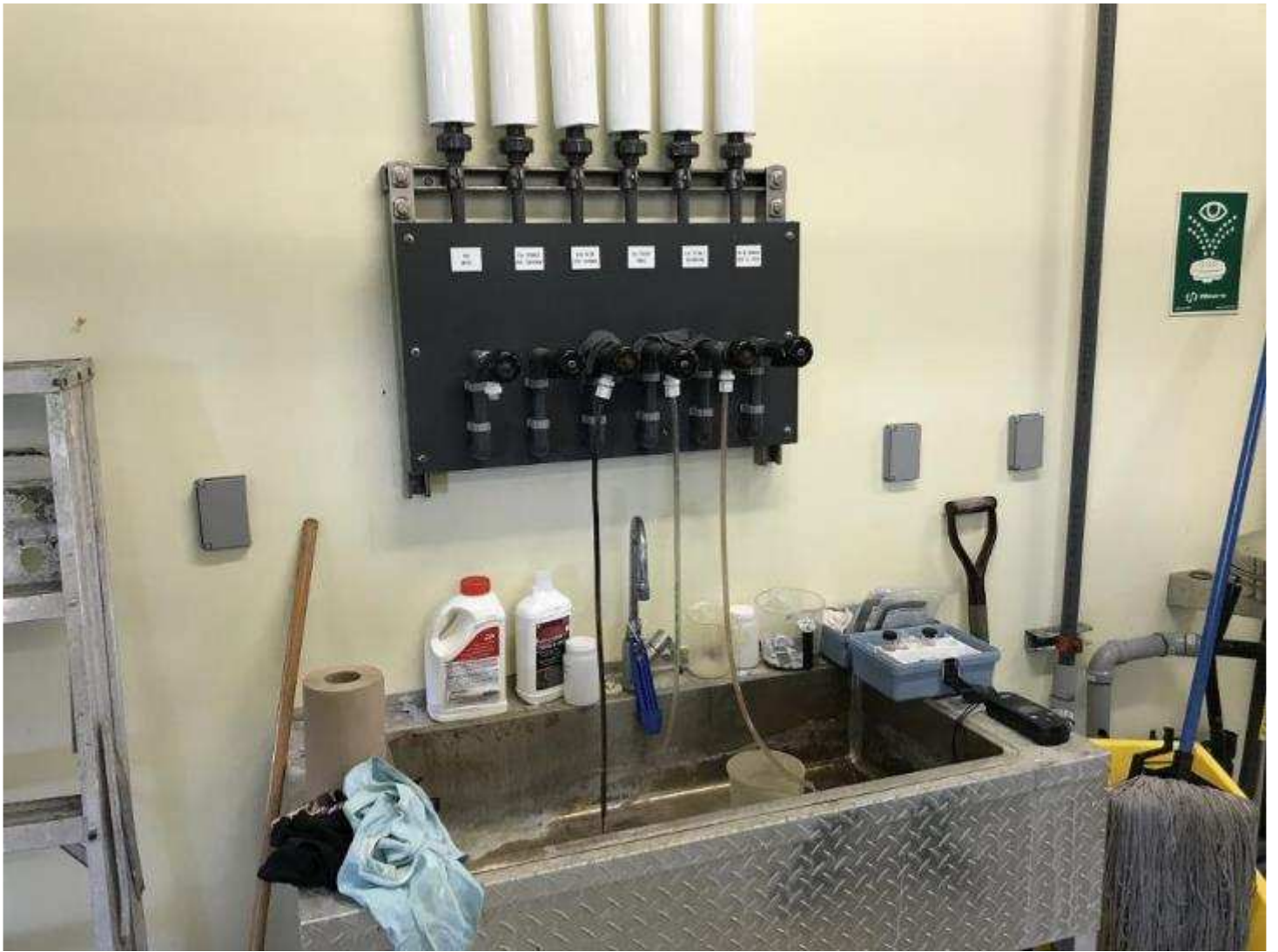
1-IMG_0382.JPG – Robinet d'échantillonnage de l'eau brute
