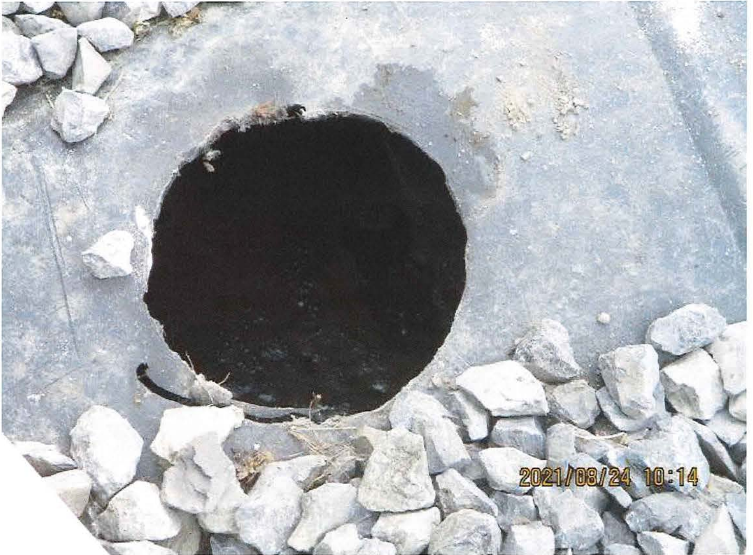
IMG_1868.JPG Matières fécales/eaux usées à l'intérieur du baril (terrain 130).
