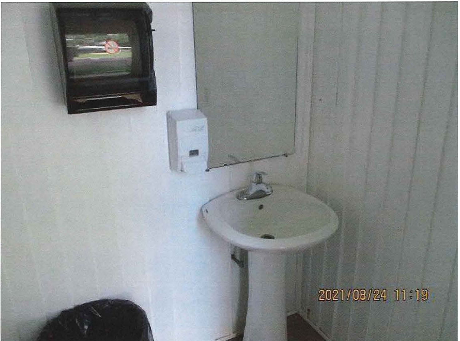
IMG_1893.JPG Bloc sanitaire 2, lavabo sans pictogramme "eau non-potable"
