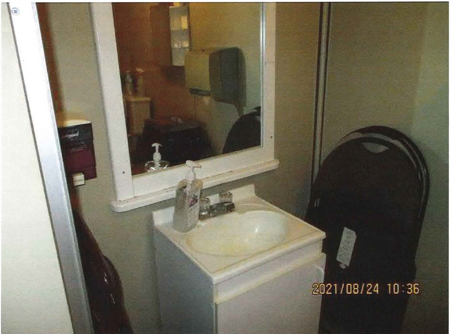
IMG_1877.JPG Salle des loisirs, lavabo sans pictogramme "eau non-potable"
