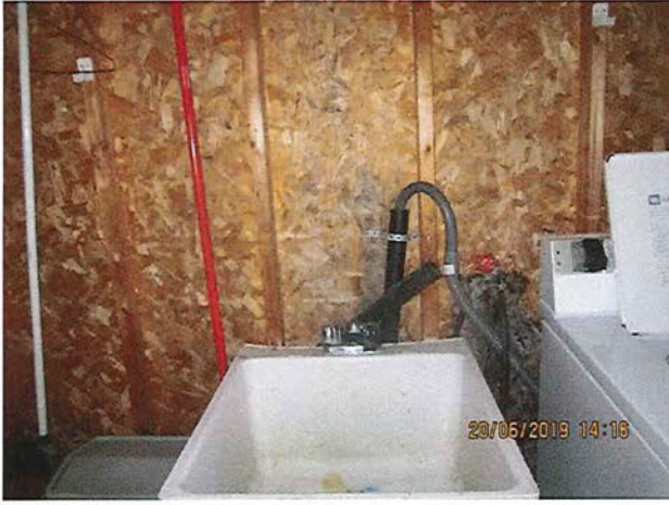
Photo # 3– Description : Buanderie avec robinet non conforme
