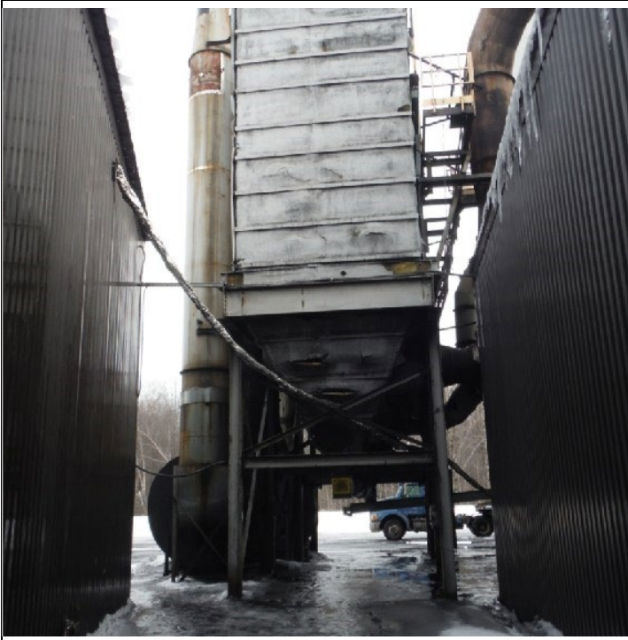
DSCF1835.JPG Photo 15: Dépoussiéreur
