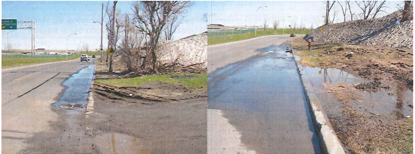
Photos 1-2 : Eaux se déversant dans le réseau d'égout de la rue Bord de L'eau.
