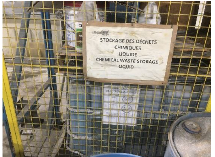
IMG_2072.jpg Photo 30 : Électrolyte de Nickel (tote 1) entreposé sans bassin de rétention et sur plus d'un (1) an.
