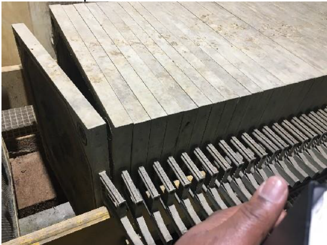
IMG_2065.jpg Photo 29 : Filtres du système démontés pour raison de maintenance.
