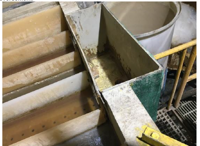
IMG_2064.jpg Photo 28 : Système traitement en fonctionnement - Écoulement d'un filet d'eau.
