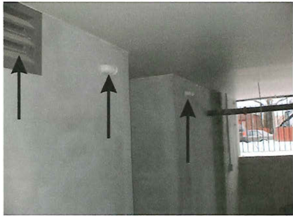
N° 7: Événets et grille d'aération
