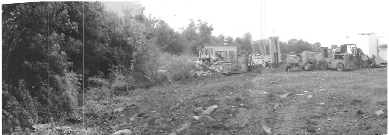
Photo 1 : Remblai et entreposage de matériaux secs, machineries et autres objets.
