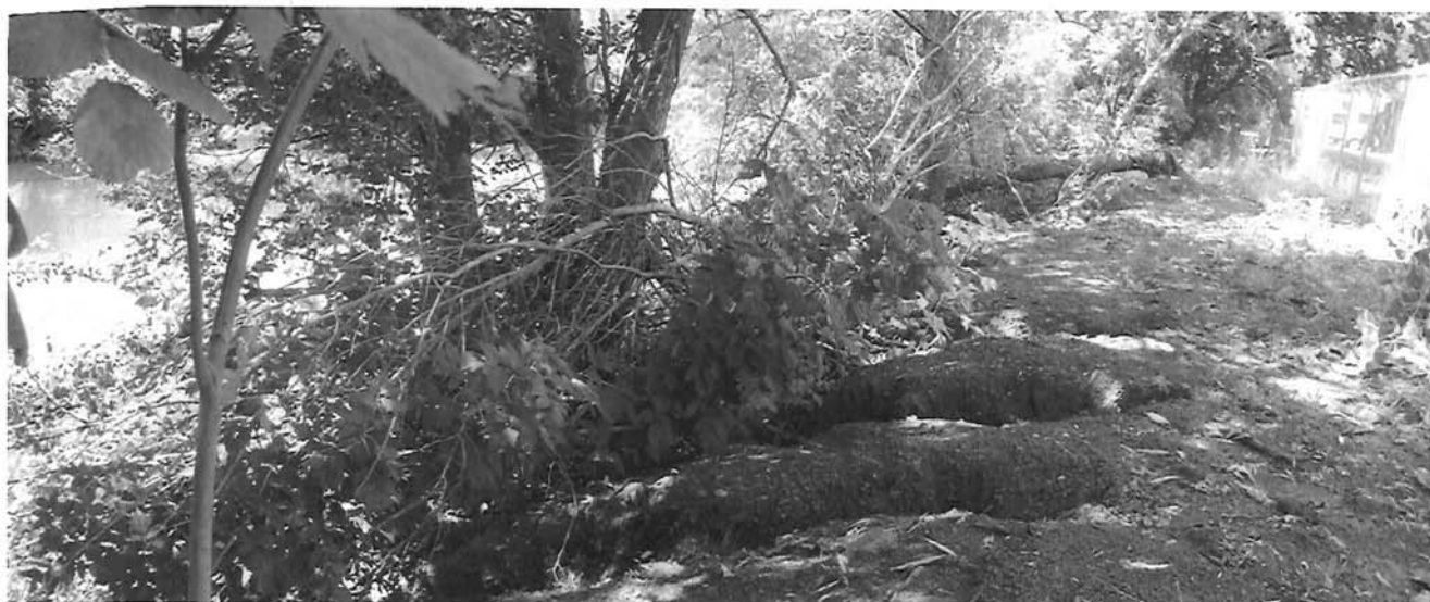
Photo 3 : Remblai et ravinement du talus de la bande riveraine.
