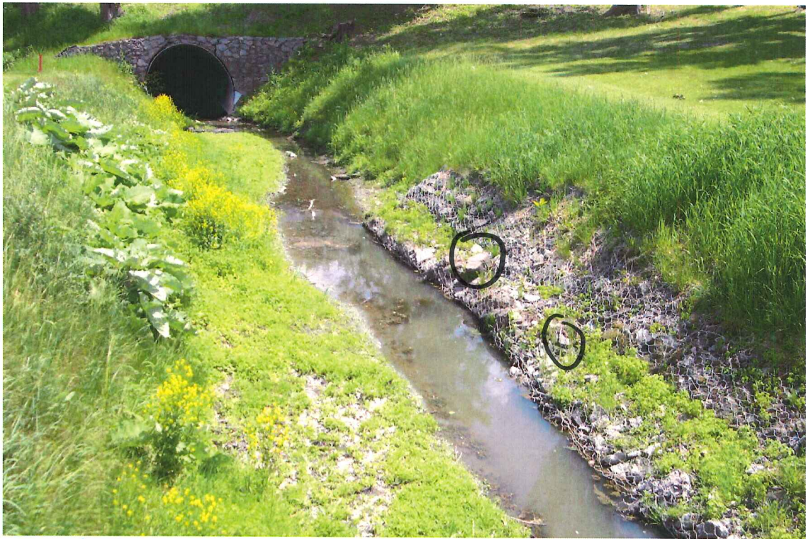
photo 7 : Troncs d'arbres visibles au Travers les gabions
