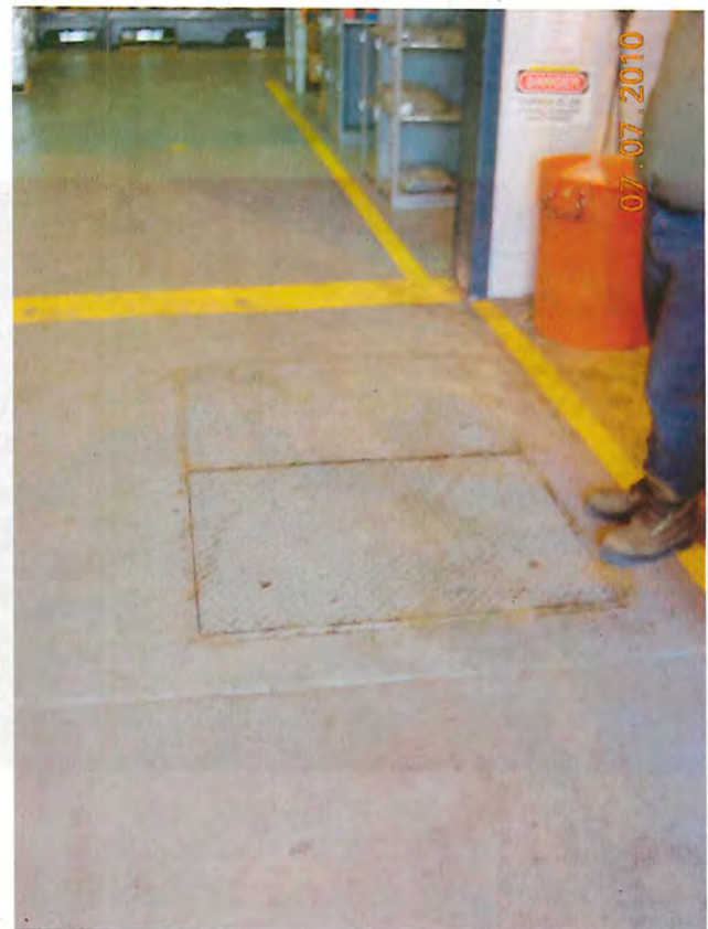
Trappe du séparateur eau/huile située dans le bâtiment.
