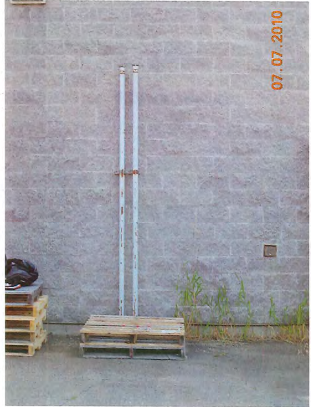
Évents du réservoir souterrain.
