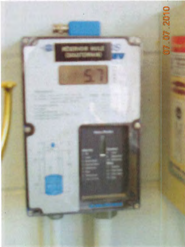
Indicateur de niveau.
