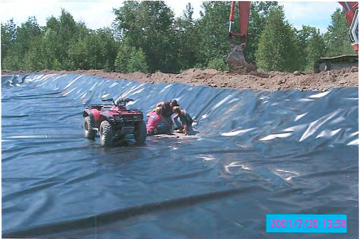
Photo no. 1: Installation du drain principal sur la membrane. Des employés de la compagnie F.R. Liners effectuait l'étanchéisation autour du drain principal qui se trouve au centre de la cellule étanche et non plus à l'est selon les plans fournis.
