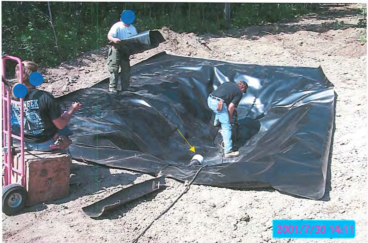
Photo no. 2: Étanchéisation des conduites du bassin de décantation. Le point GPS Nad 1983 UTM 002 a été prélevé à cet endroit (voir carte 2). Flèche jaune : Cette conduite de 6 pouces de diamètre en PVC est sur-élevée par rapport à l'autre qui mène au cours d'eau.
