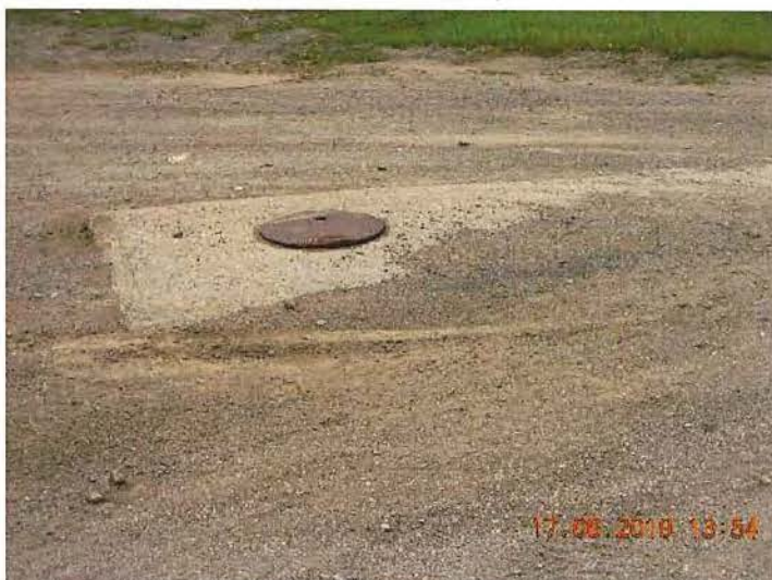
DSCN1929.JPG Puit pour détecter les fuites
