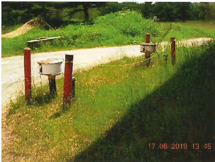
DSCN1927.JPG Réservoirs souterrains
