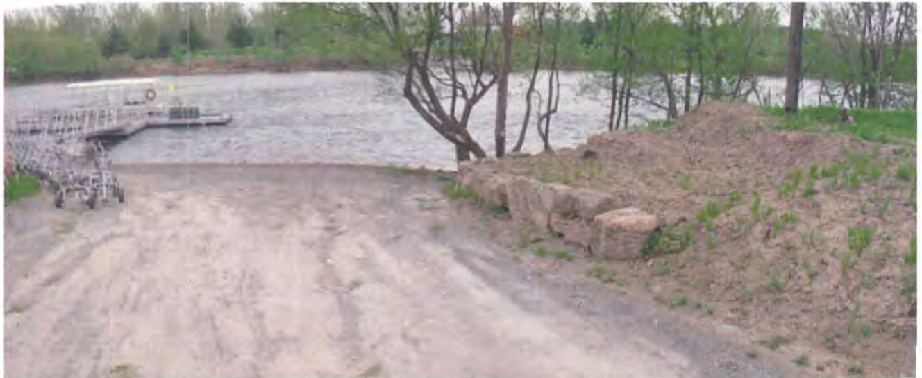
Photos 1 et 2 : Descente pour accéder à la traverse. Travaux d'aménagement paysager réalisés de part et d'autre de la descente; pierres mises en rive (vue sur la rive à l'ouest de la descente).
