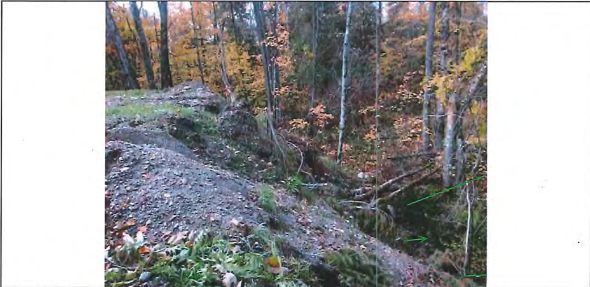
37664f56-557f-4ddb-af2c-9d6a2bcd4542 (2)débris végétaux .jpg Crevasses d'érosion du remblai, débris végétaux, partie nord du marécage, vue direction nord-ouest (vert)
