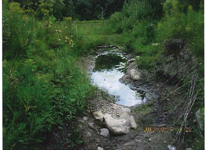
photo 8 petite accumulation d'eau entre le remblai et le fossé
