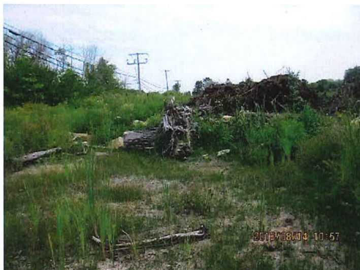
photo 5 dépression au bout du remblai
