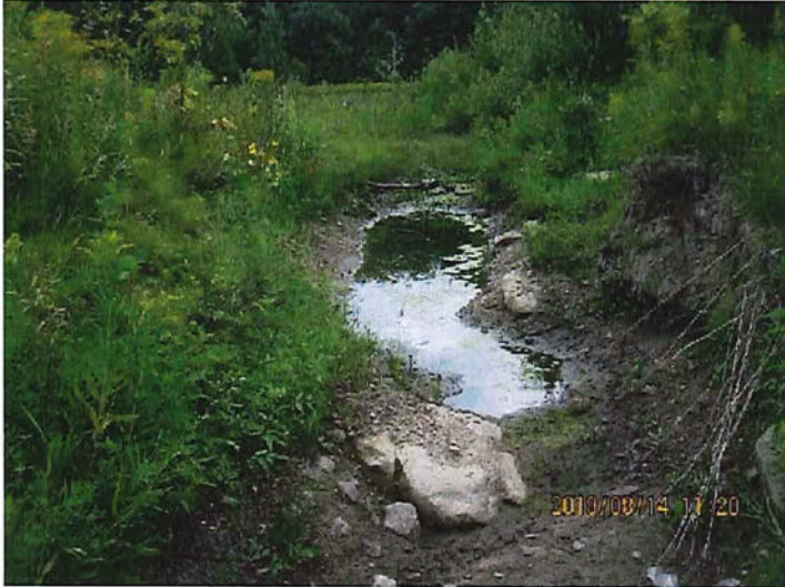
photo 9 petite accumulation d'eau entre le remblai et le fossé
