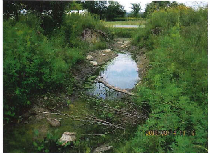
photo 10 petite accumulation d'eau entre le remblai et le fossé
