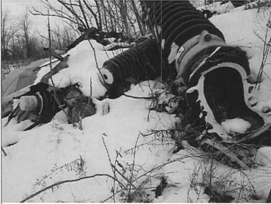
IMG_1009.JPG 7-Isolateur électrique
