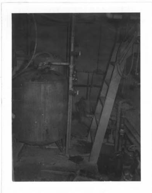
Un des deux filtres sous pression et l'échelle menant à la trappe d'accès au décanteur et à la réserve.
