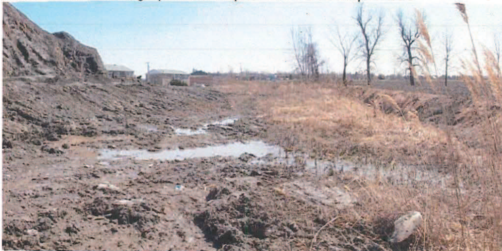
Photos 4-5 : Eaux de fonte qui ruissellent directement au ruisseau sans se rendre au bassin de décantation.
