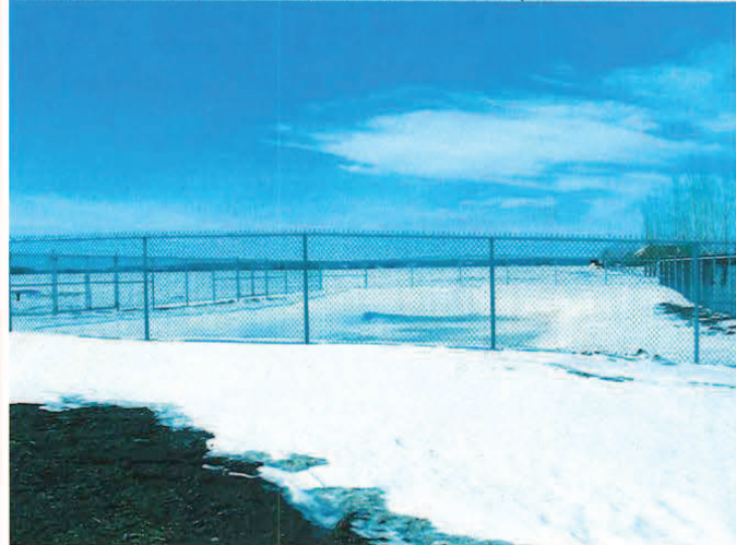
Photo 3 : Bassin de décantation. La clôture ne fait que le pourtour du bassin et non comme prévu au plan.
