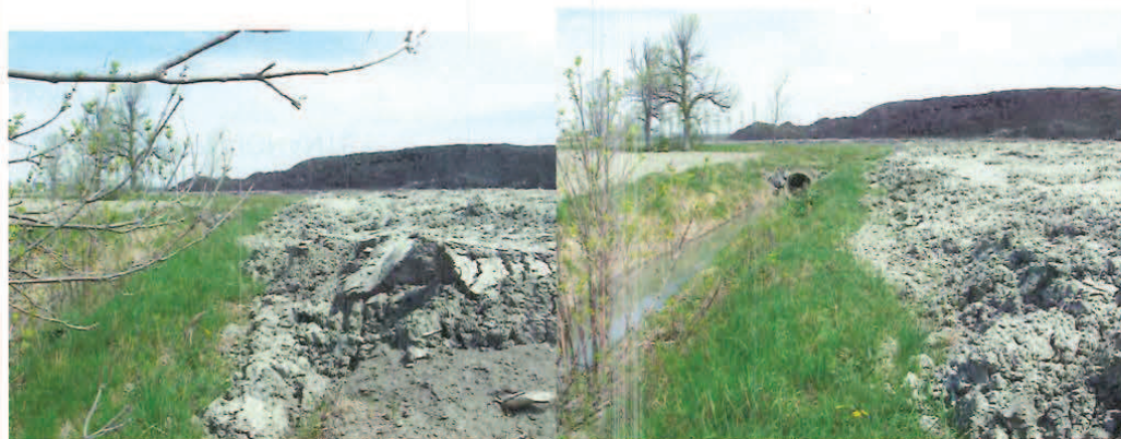
Photo 1 et 2 : Remblai dans la bande riveraine de 10 mètres du ruisseau des Trente
