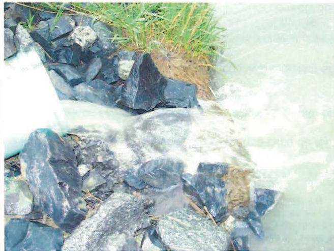
Photo 15 : L'enrochement à l'émissaire pluvial est non conforme au CA
