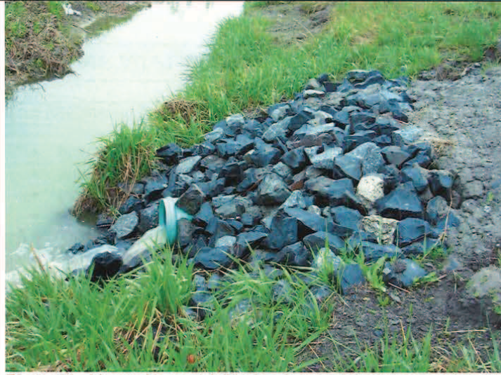
Photo 14 : L'enrochement à l'émissaire pluvial est non conforme au CA
