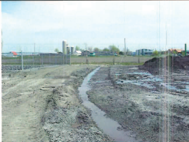
Photo 9 : Rigole aménagée pour diriger les eaux de fonte vers le bassin (côté nord ouest)
