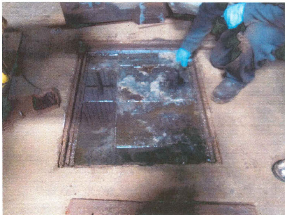
Photo 005.jpg Séparateur eau huile non entretenue: plein lors de l'inspection.
