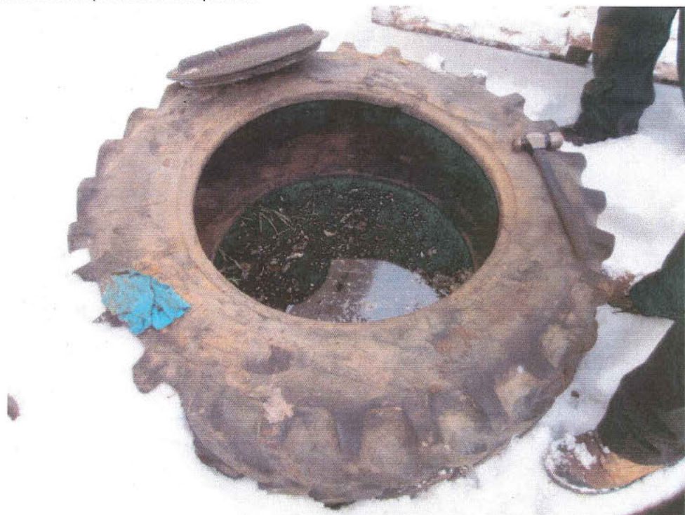
Photo 006.jpg Réservoir souterrain à simples parois relié au séparateur eau huile. Il débordait lors de l'inspection.
