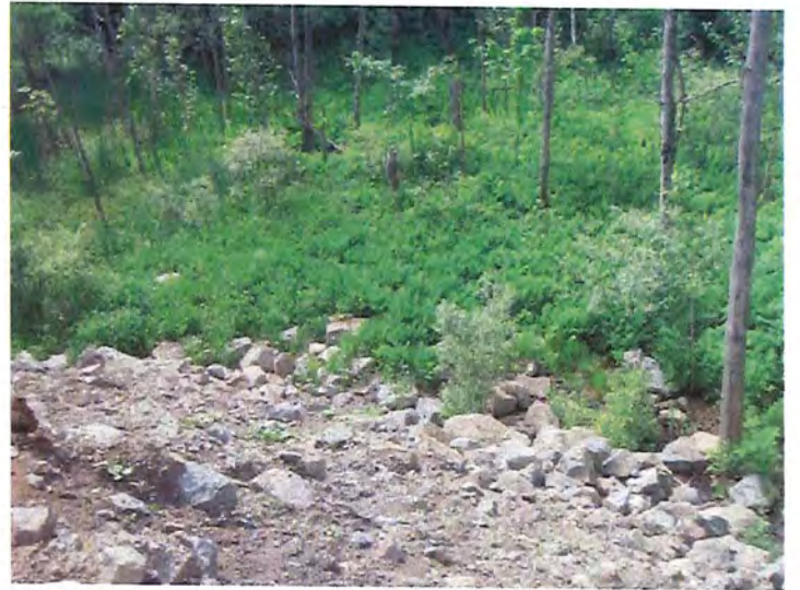
2. Le talus du remblai et ce qui reste du MH
