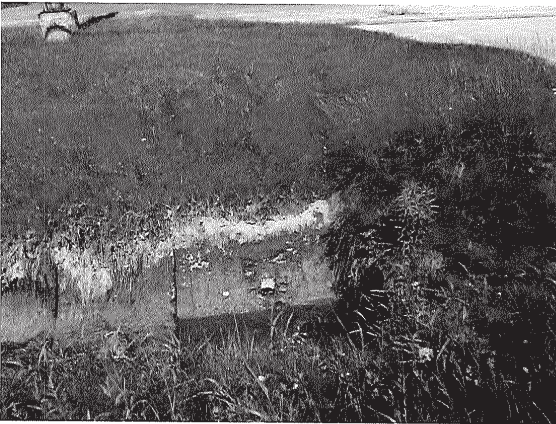
DSCF0101 (640x480).jpg Image 3. Fossé devant le 1239, route 265
