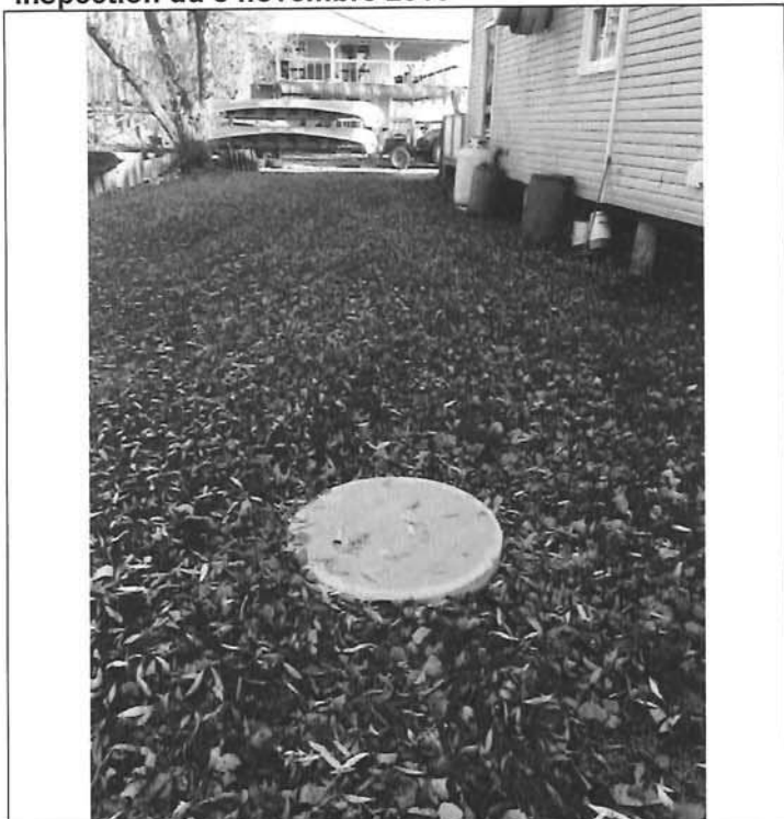
IMG_0426.JPG Couvercle de béton
