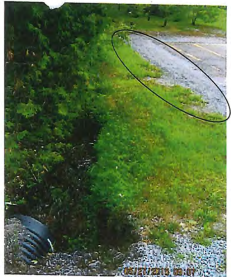
2. Les pierres concassées ayant servies d'assises aux boîtes postales sont restées sur place (IMG_0545.jpg):
