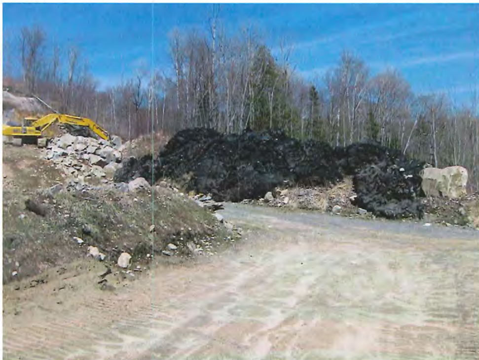
IMG_0587.JPG Des pneus de dynamitage ont été déposés sur le dessus d'une partie du mur anti-bruit localisé à l'extrême Ouest.
