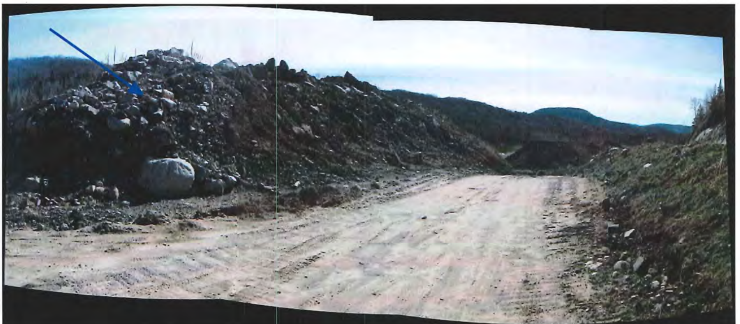
IMG_0602 Panorama.jpg La flèche indique le mur anti-bruit non prévu au CA.
