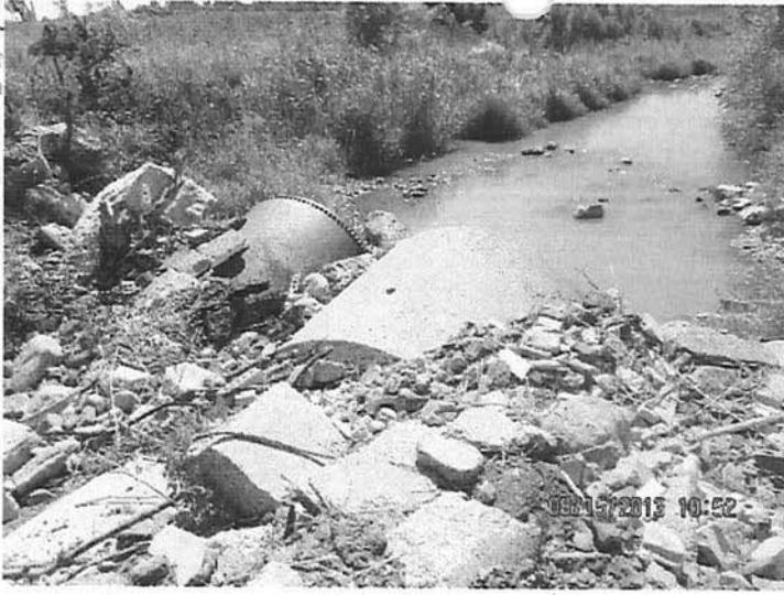
Photo 009.jpg Vue du ponceau crevé.
