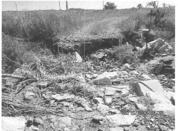
Photo 002.jpg Vue du ponceau crevé.
