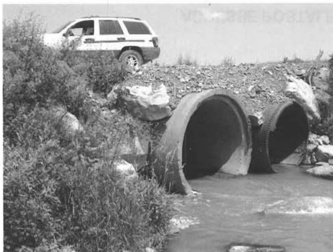
photo 1 (DSCN2384) : Ponceau aménagé pour la traverse de la rivière de l'Esturgeon. Aménagement non conforme aux critères de la fiche technique no 8.
