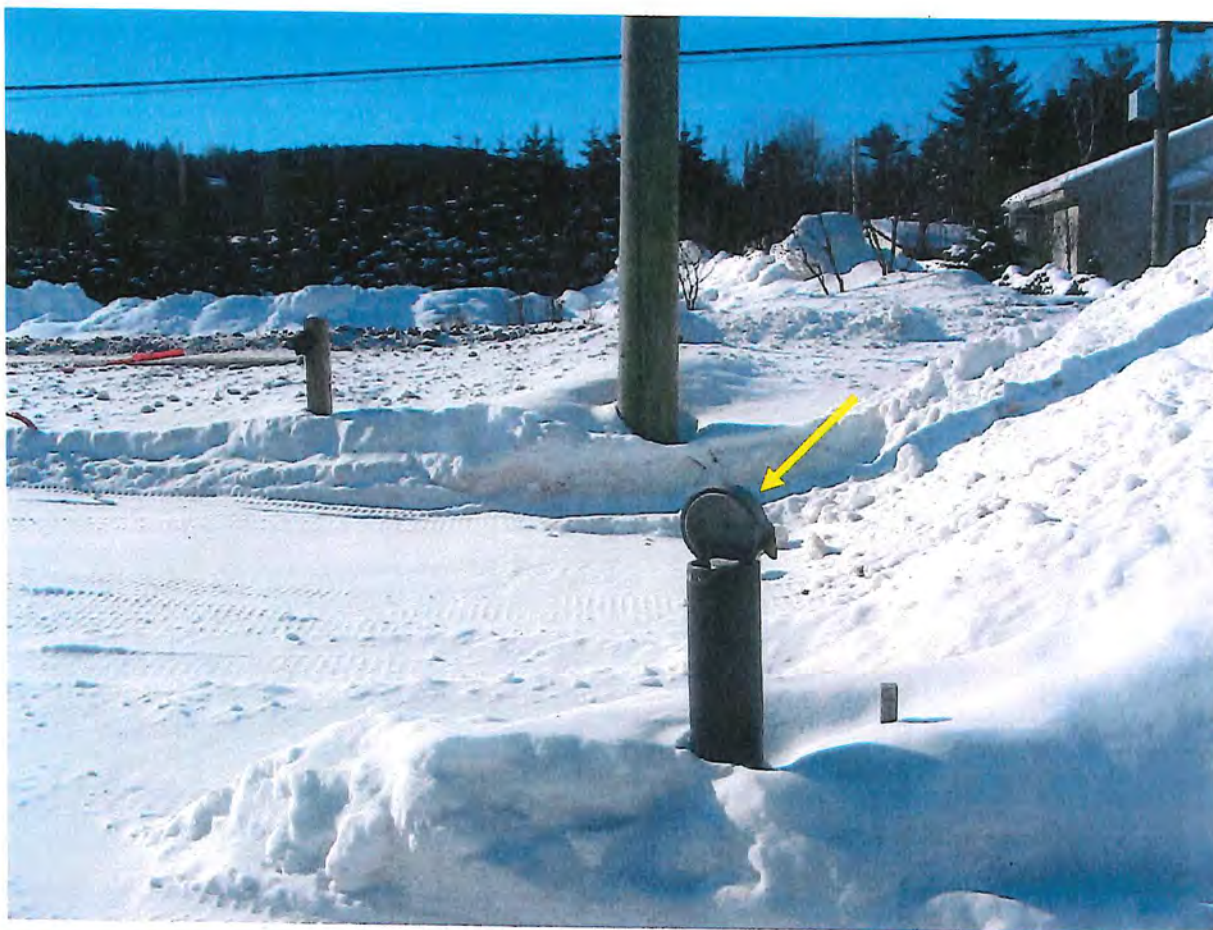
Photo no. 4 : Le couvercle du piézomètre F-1 près de la route 117 est bien cadenassé mais le couvercle est mal fixé à la tubulure. Il m'a été possible de retirer le couvercle je l'ai remis en place ensuite.
