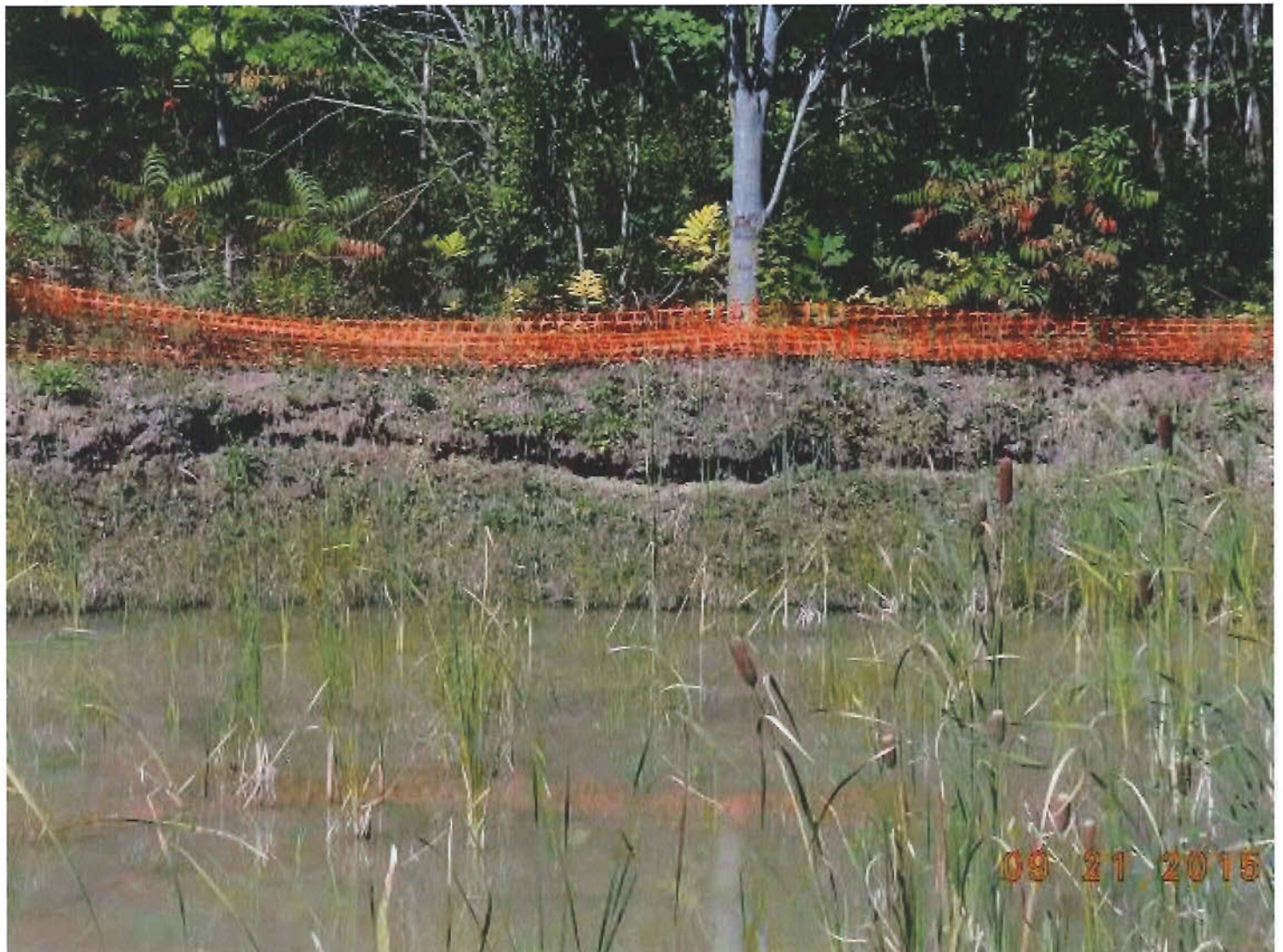
DSC05107 (640x480).jpg Affaissement du talus du bassin de biorétention numéro 2
