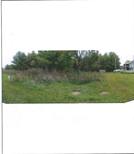
Stitched_002.JPG Photo 14. Installations de traitement des eaux usées
