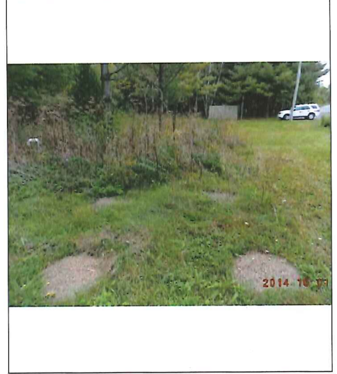
DSC02731 (Small).JPG Photo 15. Installations de traitement des eaux usées
