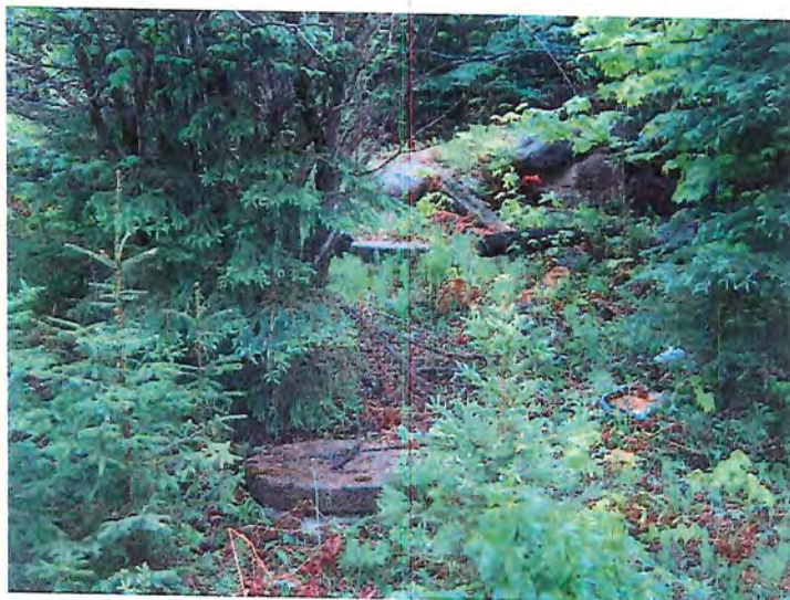
IMG_3866.JPG ⑤ Couvercles de béton d'une des deux fosses septiques.
