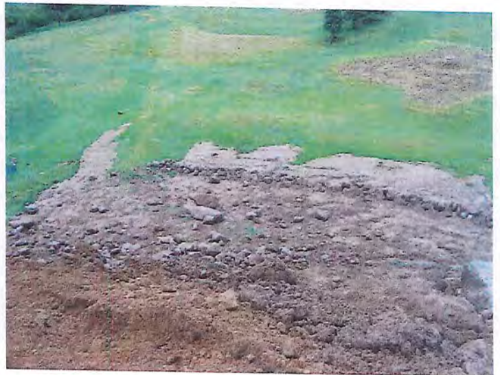
IMG_3863.JPG ④ Vue du champ d'épuration, à partir du remblai.
