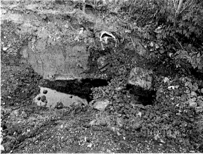
IMG_4492.JPG : État de l'excavation avant le début des travaux de récupération. Extrémité Est
