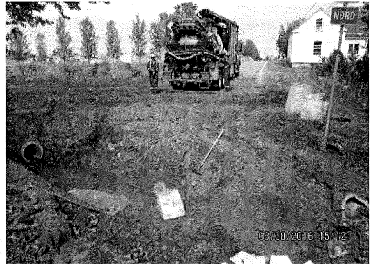
IMG_4497.JPG : Camion de pompage RSR
