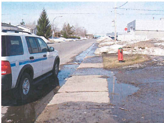
Photo 3 : Ruissellement des eaux de fonte en provenance du stationnement derrière le garage
