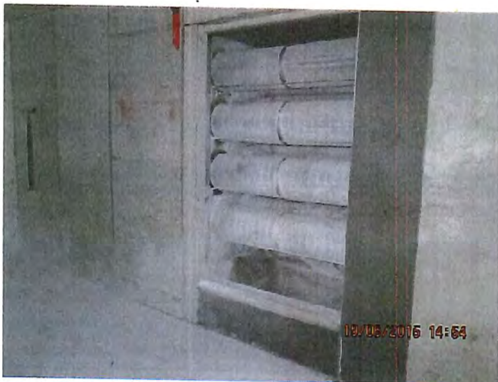
Photo 3 : IMG_0606.jpg : Filtres à cartouches
