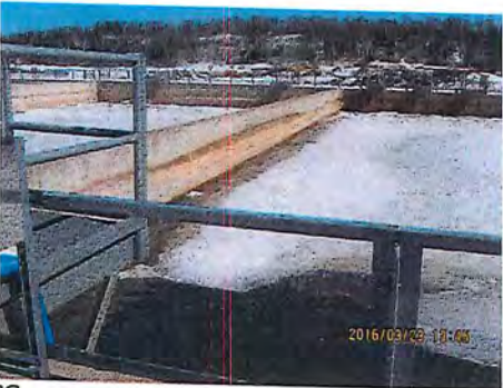
⑤ IMG_3740.JPG Bassins de traitement du lixiviat.
